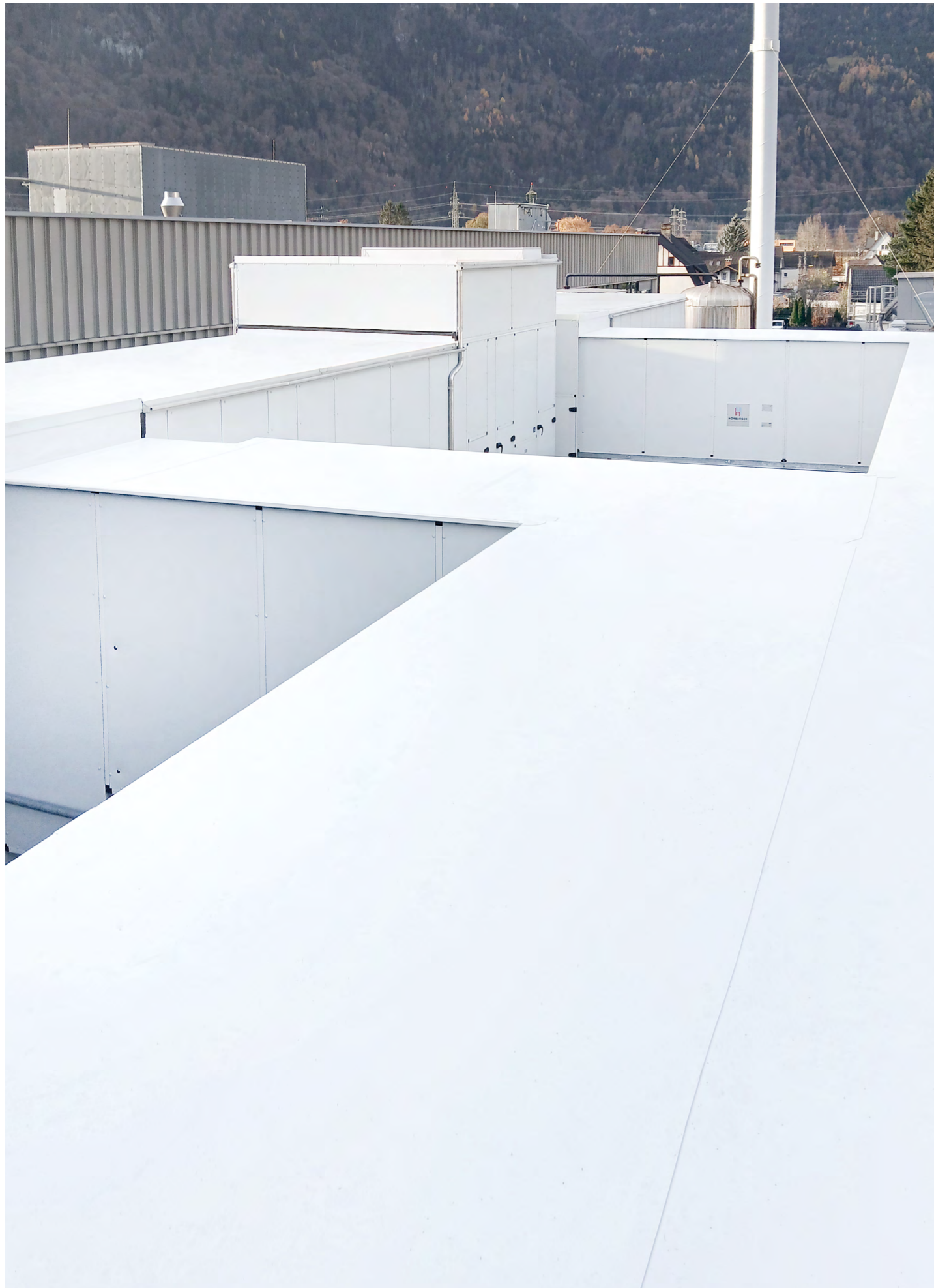
Zu- und Abluftkanalsystem mit Sarnafil-Dach.
