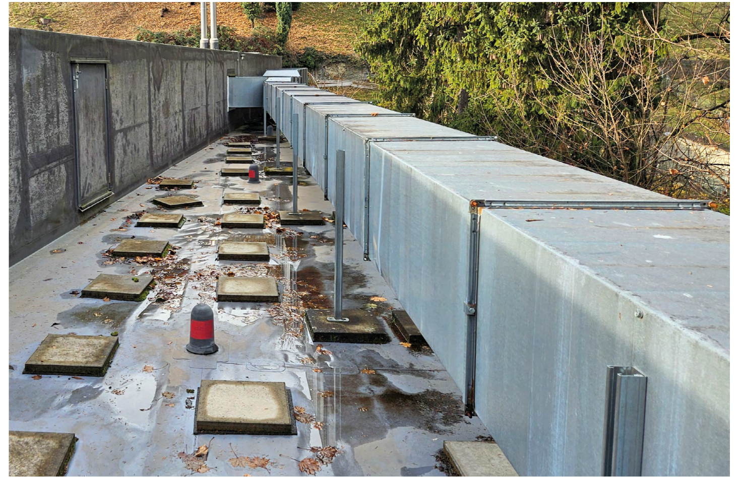
Unzureichende Befestigung sowie fehlende Sturmsicherung.
