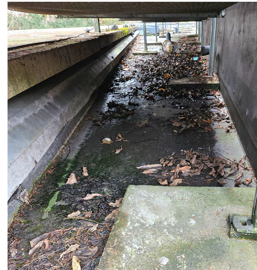
Eingeschränkte Sanierbarkeit des Daches.
