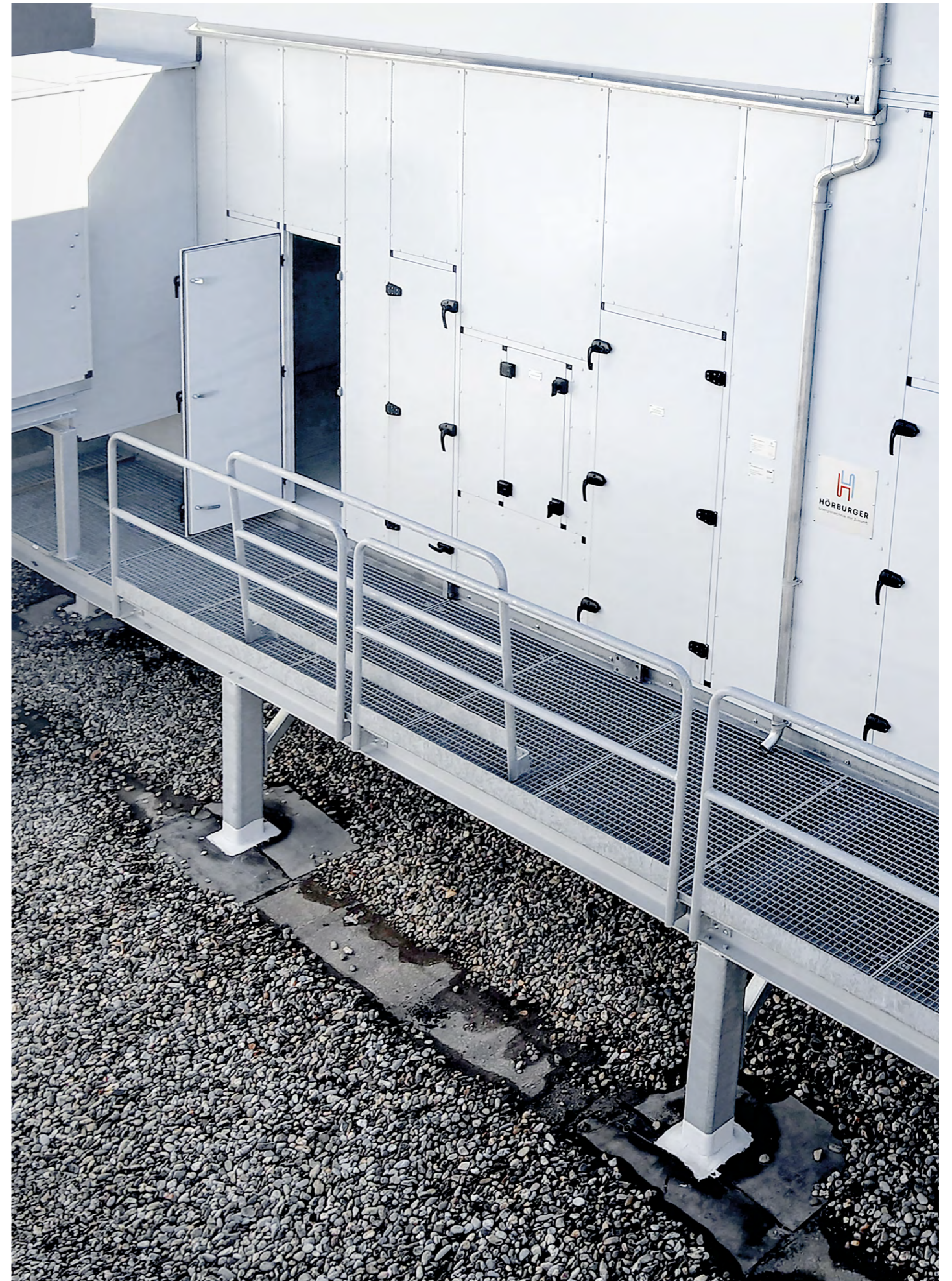
Anschluss an die Gerätezentrale.
