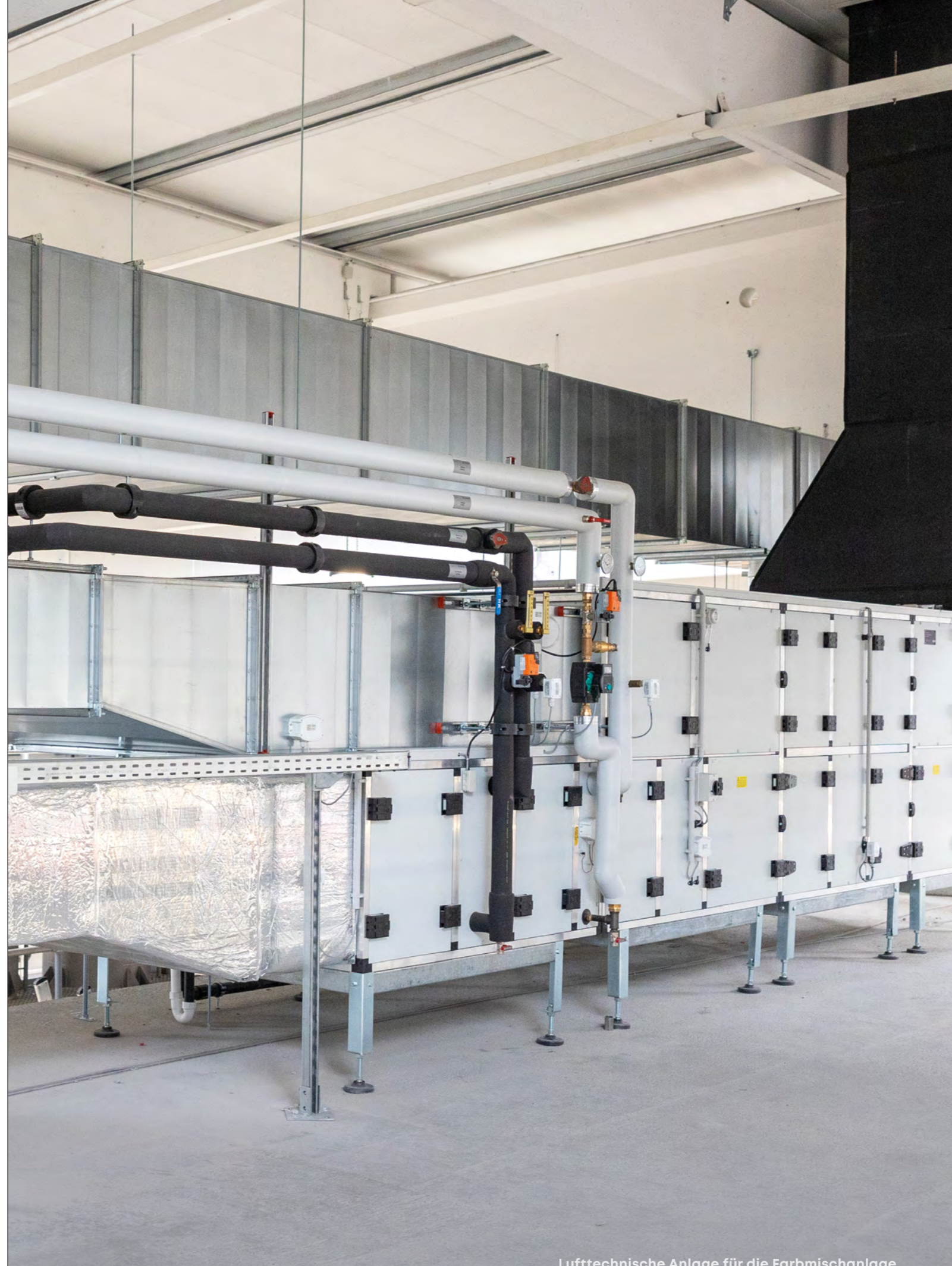
Lufttechnische Anlage für die Farbmischanlage.
