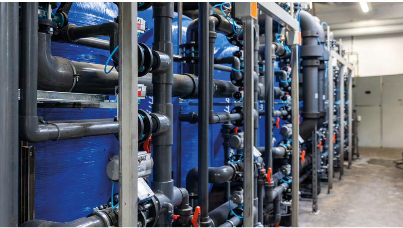
Zentrale Wasseraufbereitung. Fotos: broell.cc
