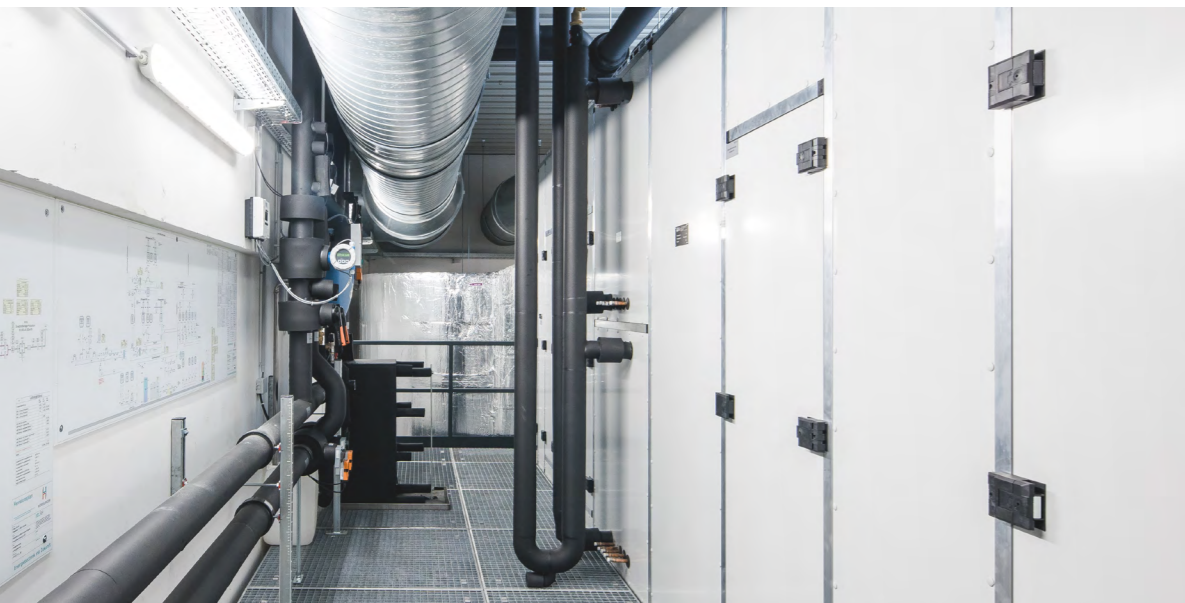
Optimale Zugänglichkeit für die Wartung und den Betrieb der Anlage. Fotos: broell.cc
