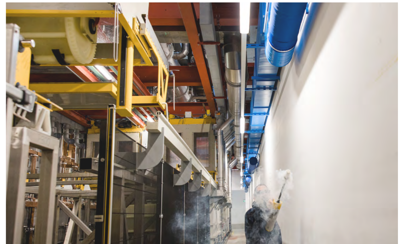
Impulsarme Zuluft einbringung zur Ausbildung eines Frischluftbereiches für die Wartung und Instandhaltung.
