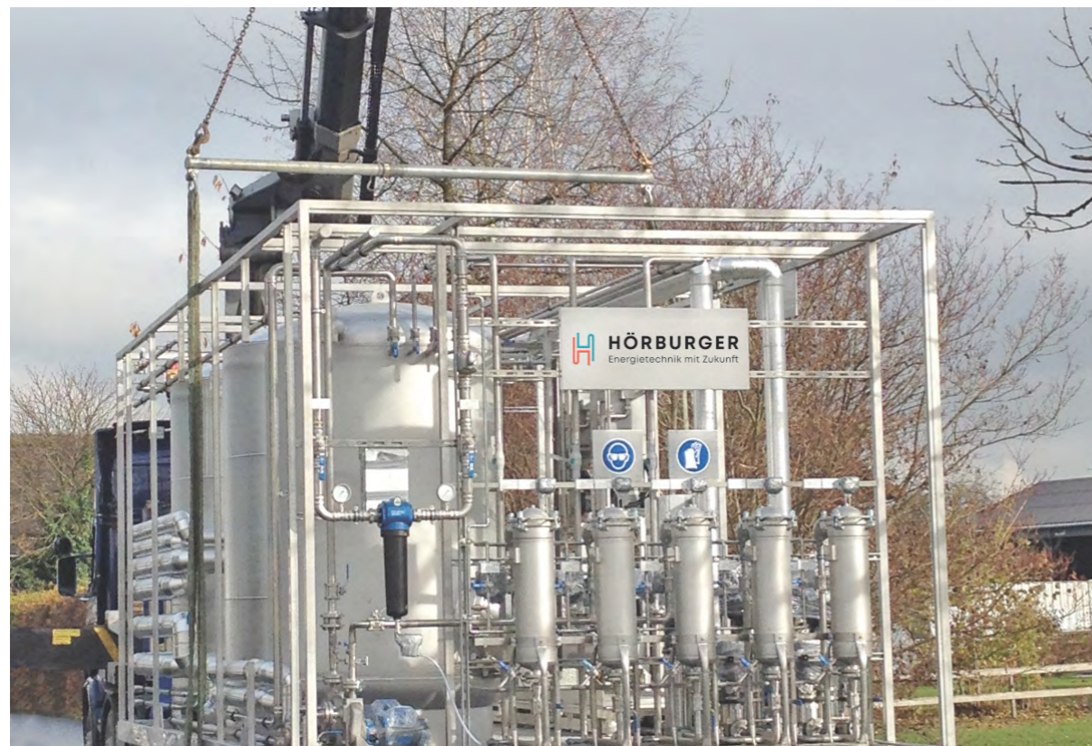
Verladung einer Anlage.
