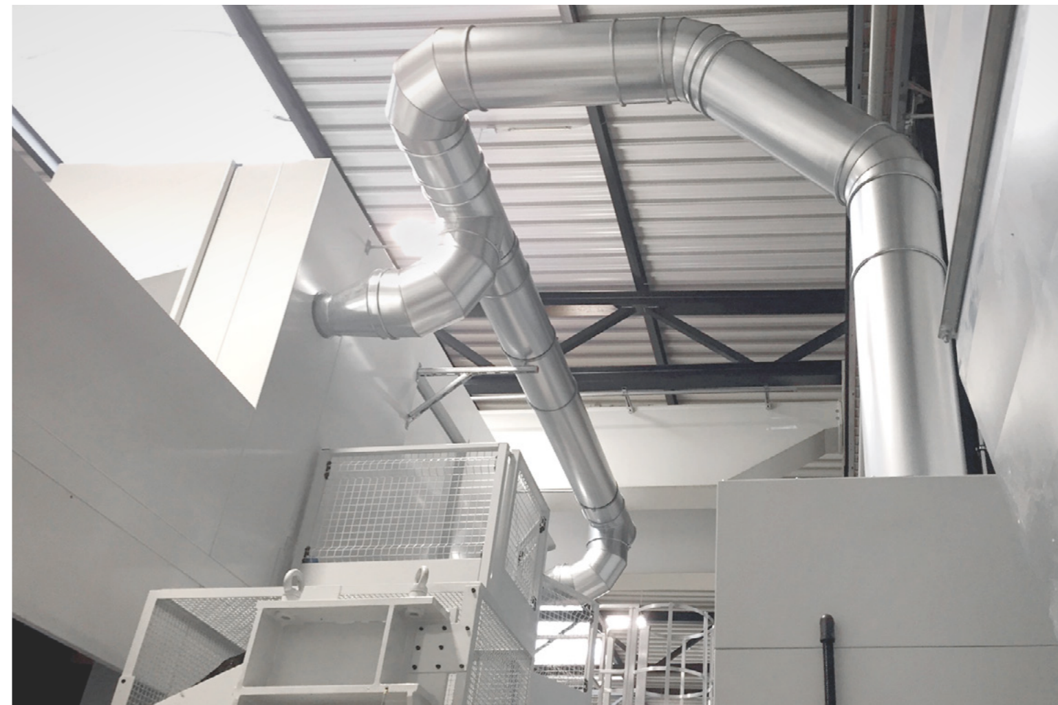
Öldichtverrohrung von der Maschine zur Absauganlage.
