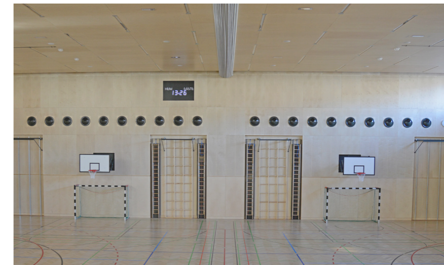
Turnhalle groß – Zuluft einbringung mit schwenkbaren Weitwurfdüsen.
