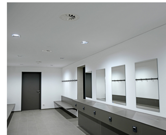
Sanitärbereich bedarfsgerecht belüftet.
