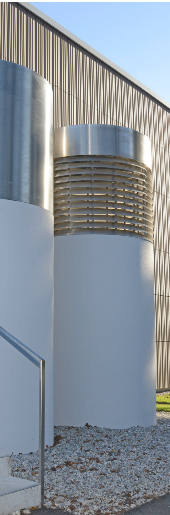
Außenluftansaugung und Fortluftaustritt Turnhalle groß.
