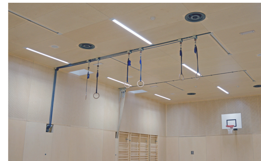
Turnhalle klein – Zuluft einbringung mit variablen Drallauslässen.
