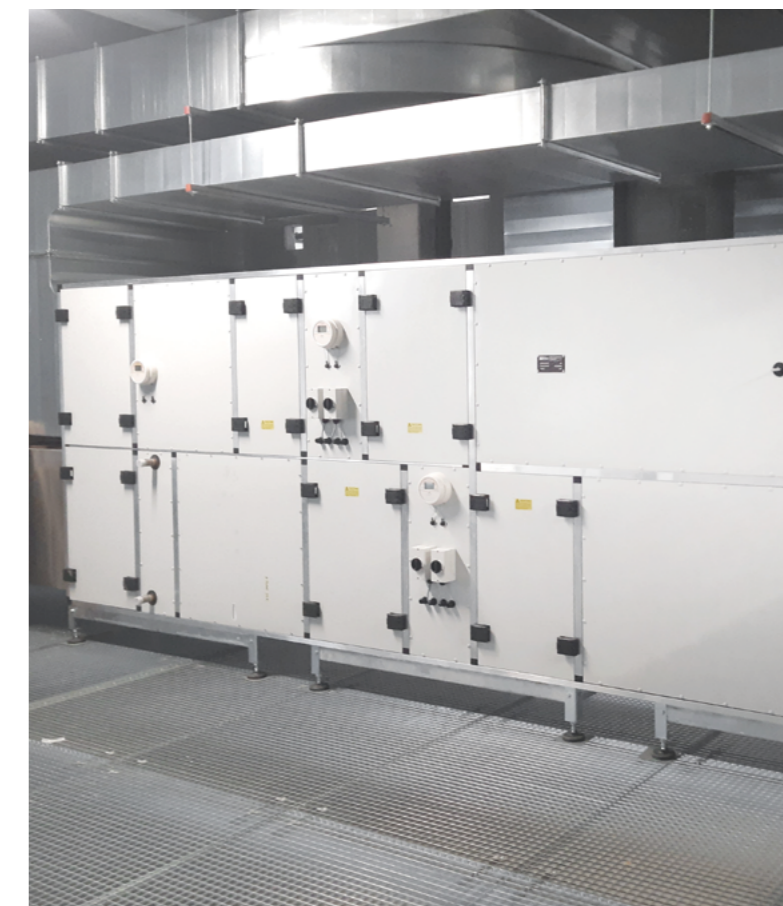
Zentrallüftungsgerät in Modulbauweise.
