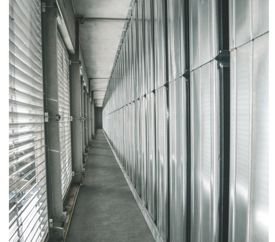
Einhaltung exakter Akustikvorgaben mittels Kulissenschalldämpfer.
