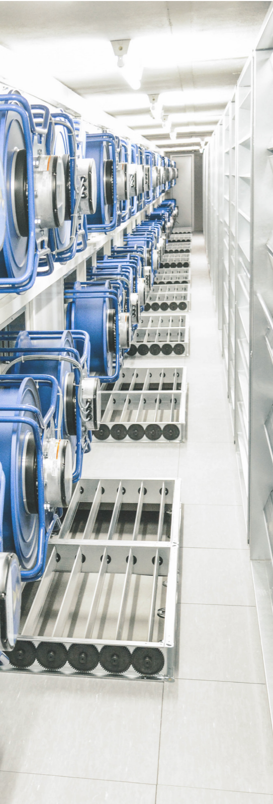
Modularer Aufbau der Fanwall und Luftmischkammern mit nachgeschaltetem Kulissenschalldämpfer.
