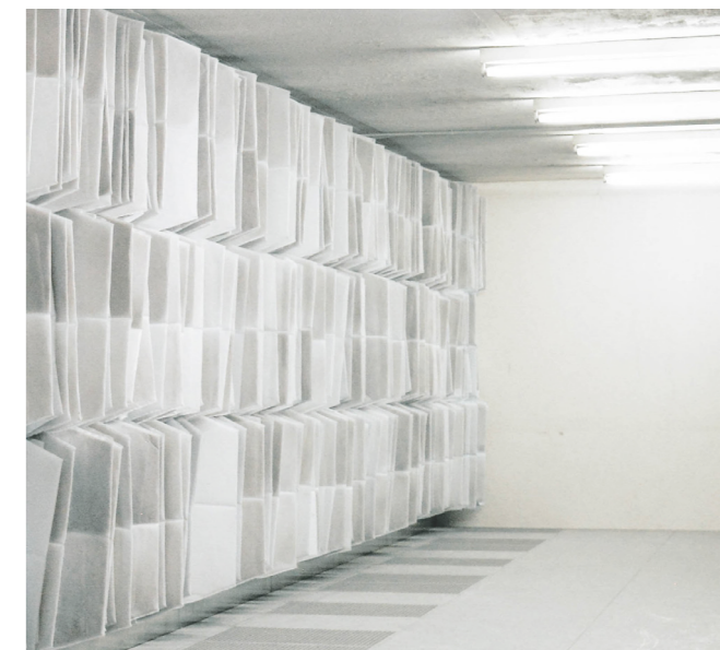
Filterung der Außenluft.
