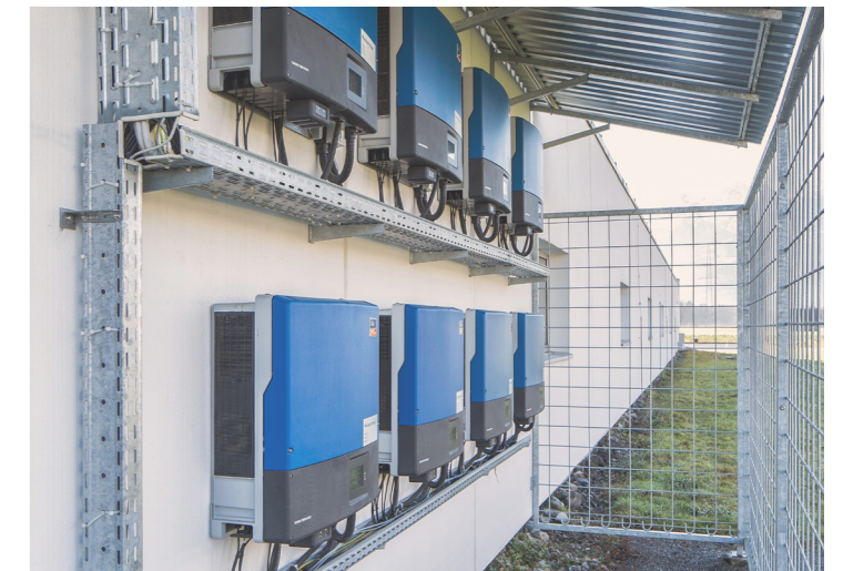
Die PV-Anlage hat eine Leistung von knapp 126 kWp und erzeugt rund 123.000 kWh Strom pro Jahr.
