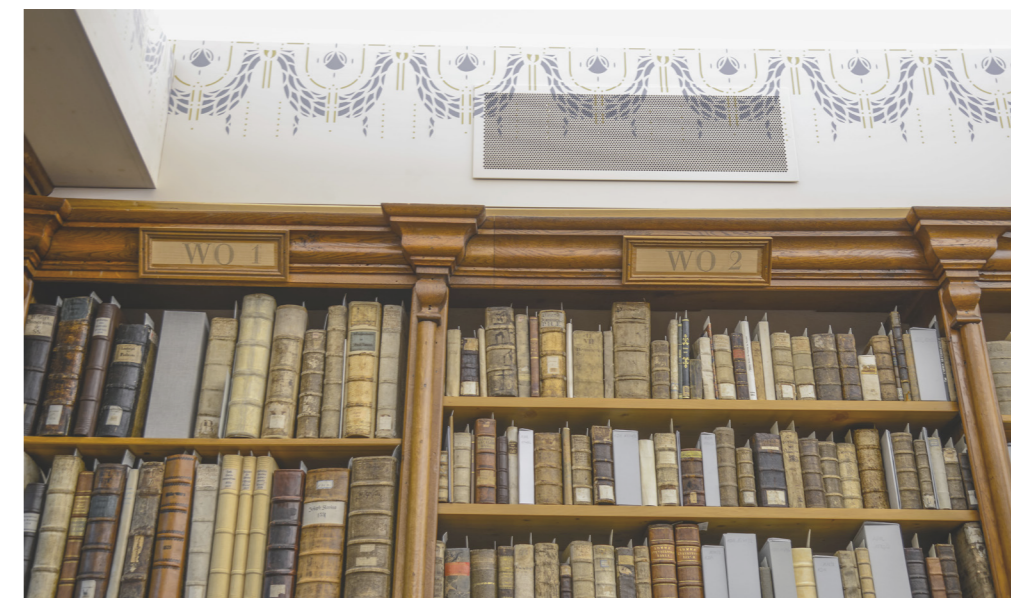
Blick auf die Integration eines Fächerluftauslasses.
