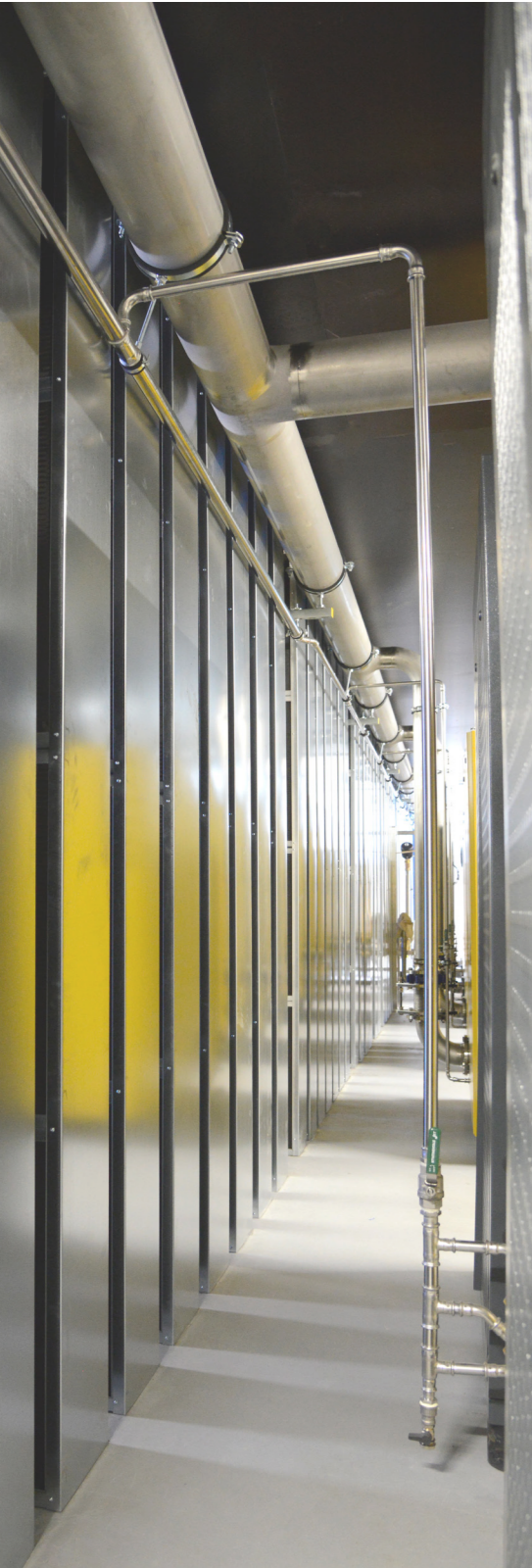
Blick in den Kompressorraum auf die Ansaugseite der Kulissenschalldämpfereinheit.
